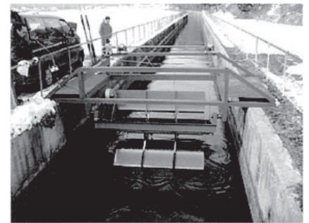
図表 16 流水利用型発電機の設置状況
